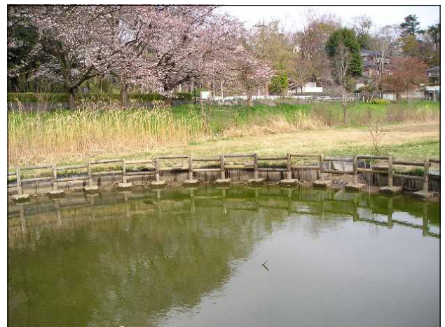
写真⑥ ため池の杭の基礎が露出
